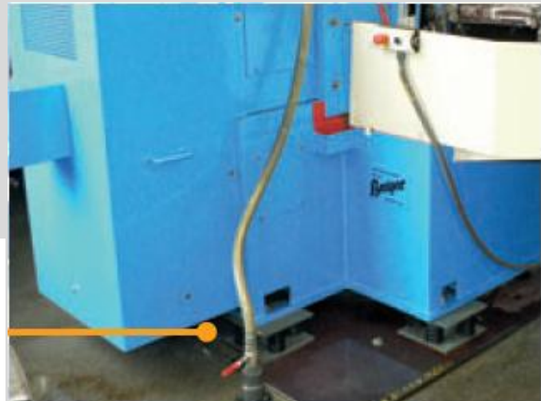
Шлифовальный станок установлен на пружинные демпферы, между пружин которых, находится колба с высоковязким средством
