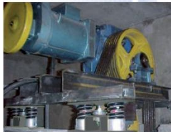
Виброизоляция привода лифта
